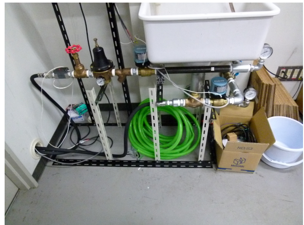
図 5.7: GM 冷凍機を駆動するための圧縮機を冷却する冷却水管理システム。循環型冷却水の流量をモニターできる。また、ホース接続部にて水漏れがあった際、自動で電磁弁を閉める安全装置を備えている。
