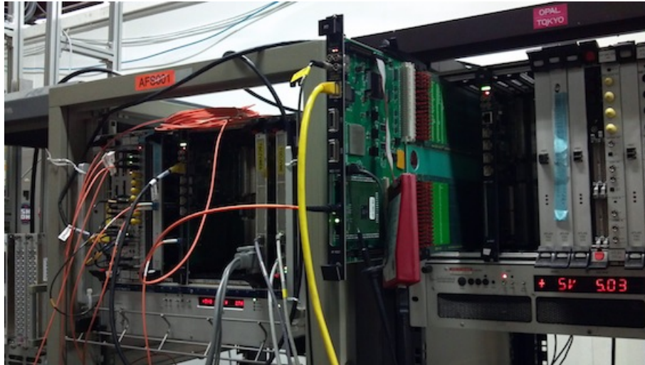
図 5.4: PT7 TTC 接続試験 環境. オレンジのケーブルが TTC 装置からの光信号を運ぶ.
